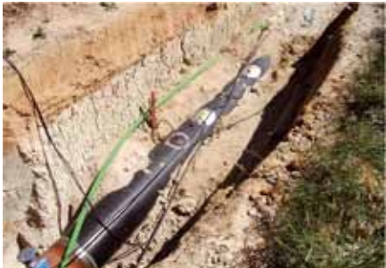
Rohrleitung mit KKS Schweißpunkten
