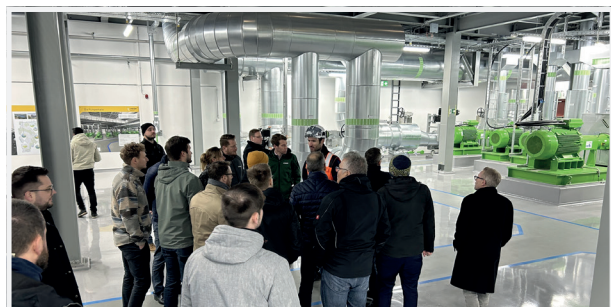
Herr Feist vom Heizkraftwerk Leipzig Süd führt einen Teil der Teilnehmergruppe durch die Kraftwerksgebäude. Foto: S. Rolwers
